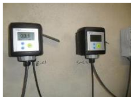
EDAR Oropesa del Mar. Instal·lació de mesuradors de SH 2
