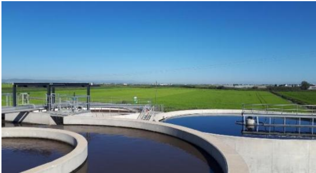
EDAR Sueca – El Perelló. Reactor biològic i decantador secundari.
