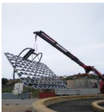
EDAR Aiello de Malferit. Substitució de graella de difusors
