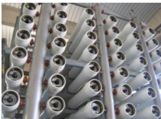
IRAD Benidorm. Membranes d'osmosi inversa
