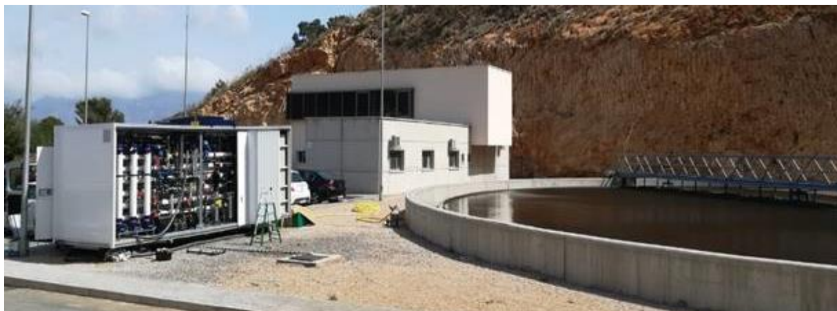
Planta pilot d'eliminació de contaminants emergents instal·lada en la EDAR de Benidorm
