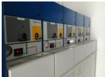
EDAR Pinedo. Cel·les del nou anell intern de subministrament en mitjana tensió
