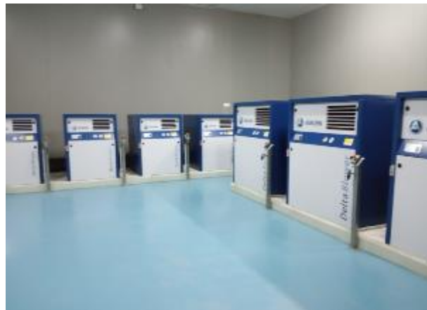
EDAR Teulada (Moraira). Sala de bufadors
