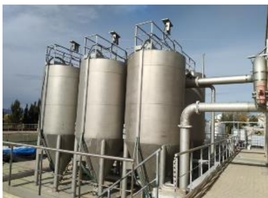
DAR Novelda – Monforte del Cid. Filtració en arena
