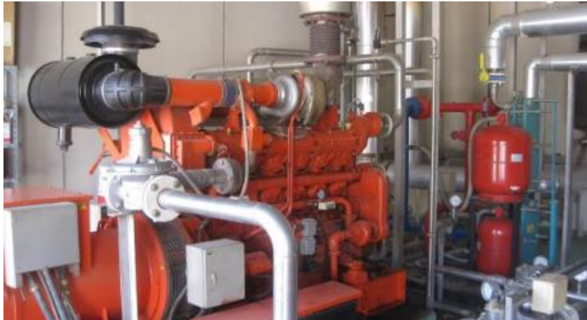
EDAR Benidorm. Motor de cogeneració
