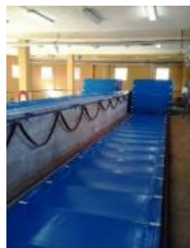
EDAR Calpe. Cobriment i desodoració dels canals de desarenament
