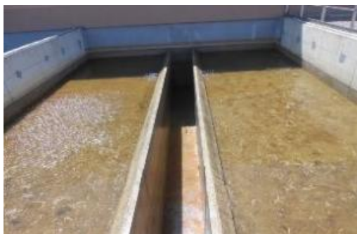
EDAR Quart - Benàger. Filtres d'arena
