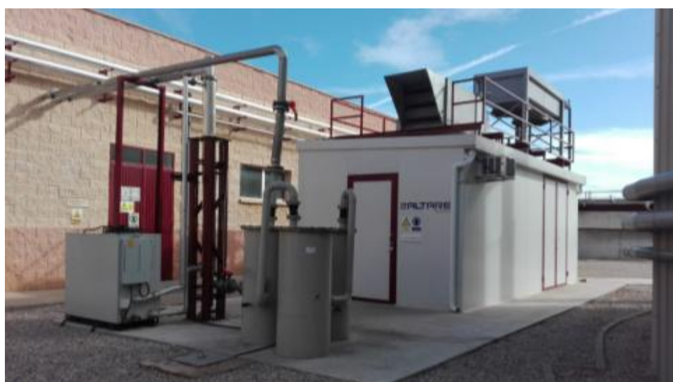
EDAR Albufera - Sud. Sistema de cogeneració
