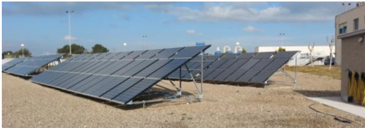
Planta fotovoltaica situada en l'EDAR del Pilar de la Horadada (Alacant).
