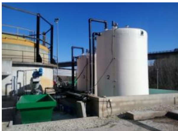
EDAR Alcoi. Condicionament i ampliació de les instal·lacions per a la gestió i valoració energètica de residus autoritzats
