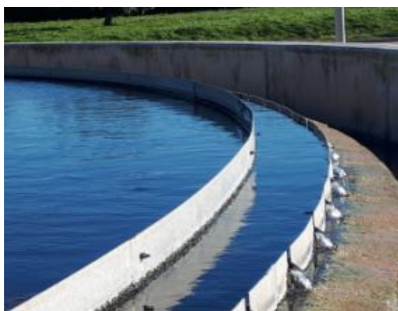
EDAR Alghemesí. Decantació secundària
