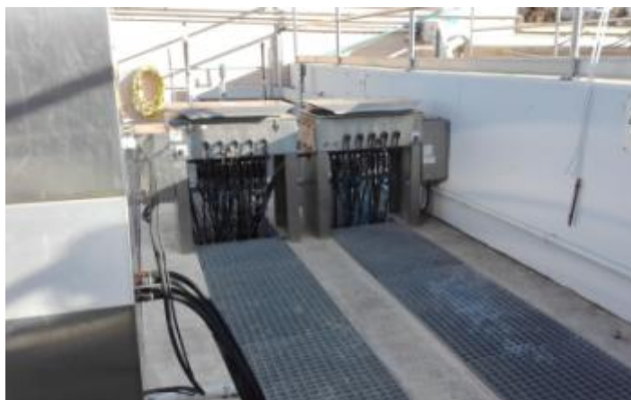
EDAR Conca del Carraixet. Desinfecció mitjançant llums UV
