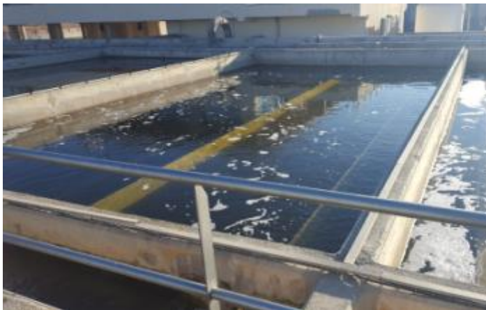
EDAR Pinedo. Filtració en arena
