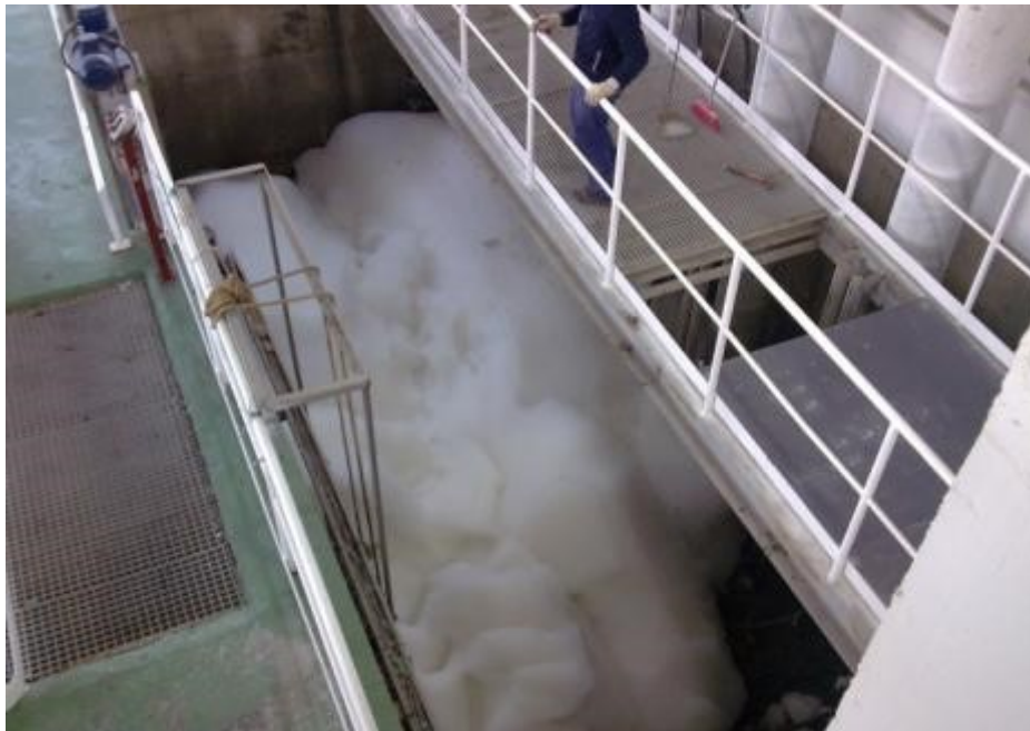
Episodi d'abocament de detergents en l'EDAR Quart Benàger
