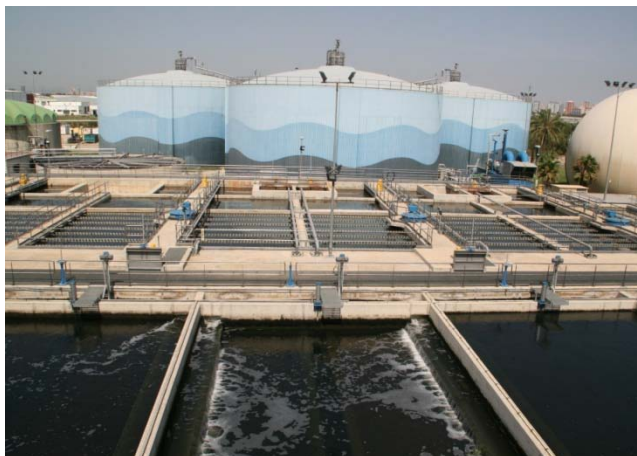
EDAR Pinedo. Etapa de filtración en arena
