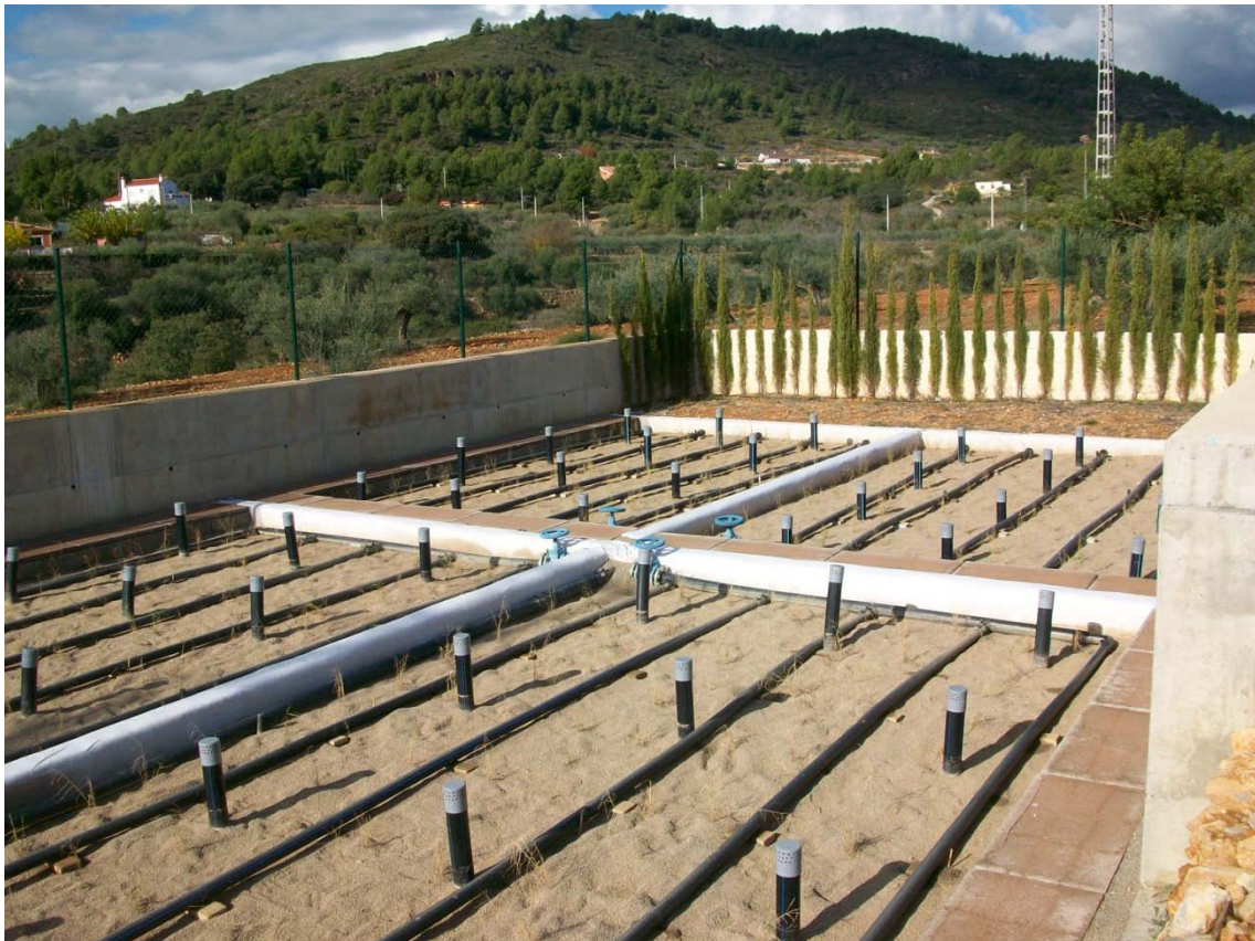
Acabados EDAR Foia de l'Alcora
