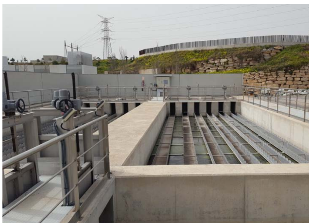
EDAR Alacantí Norte. Decantación lamelar
