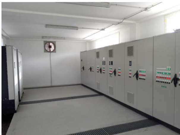
Alcoy. Centro de control de motores
