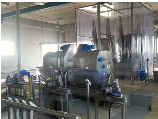
EDAR Pilar de la Horadada. Focalización de la desodorización
