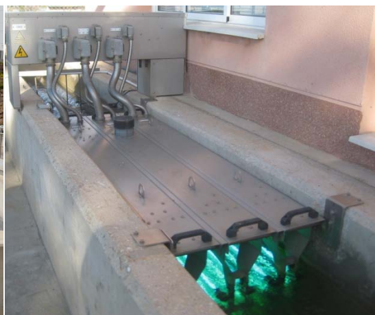
EDAR Sueca. Desinfección UV
