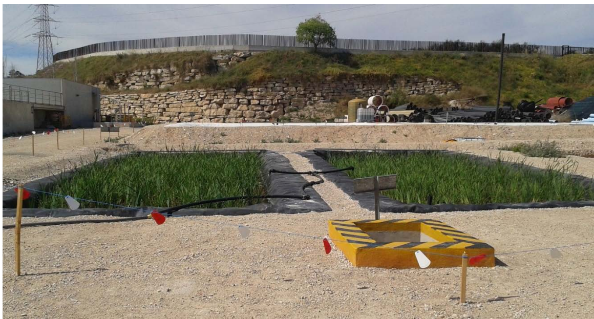
EDAR Alacantí – Norte. Humedales artificiales
