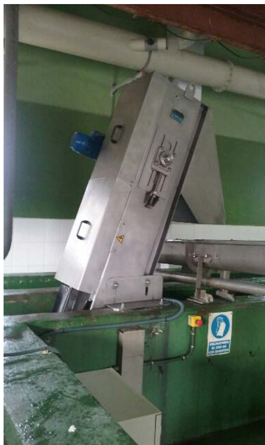
EDAR Aspe. Nueva reja de desbaste automática en pretratamiento
