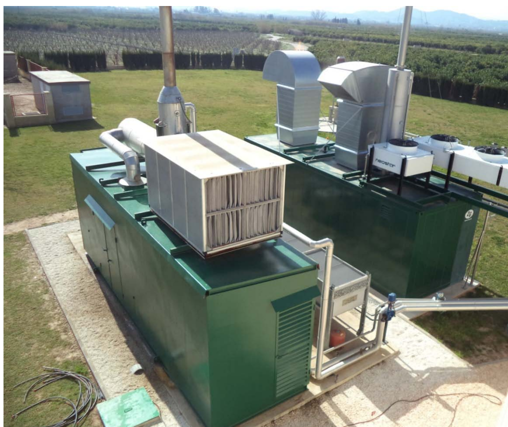
Sistema de cogeneración EDAR Alzira - Carcaixent
