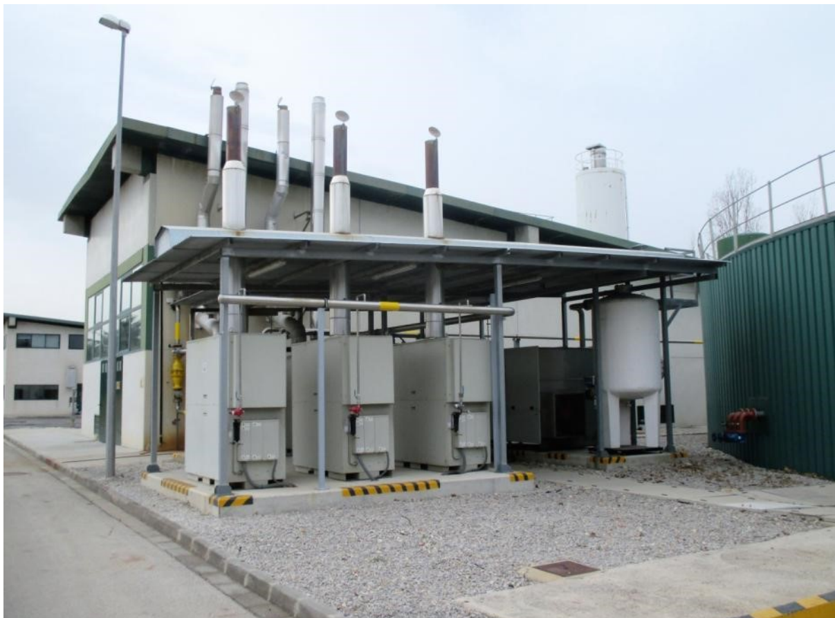
Sistema de cogeneración mediante microturbinas. EDAR Paterna – Fuente del Jarro
