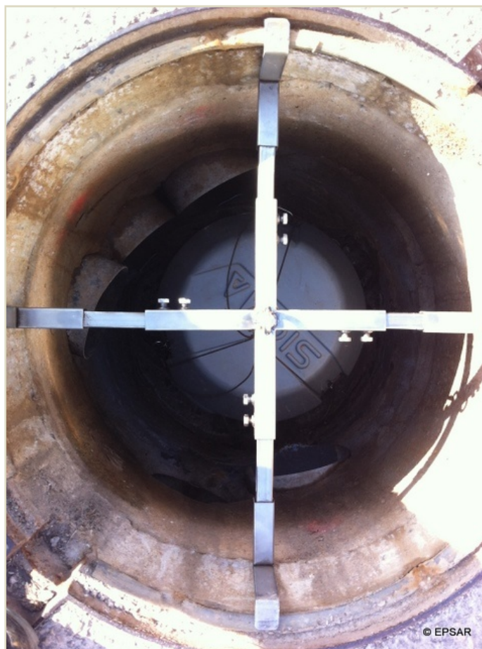
Instalación de tomamuestras en el interior de una arqueta durante una inspección
