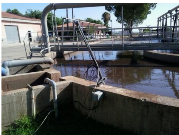
EDAR Pego. Instalación de sonda de amonio para optimización del tratamiento biológico
