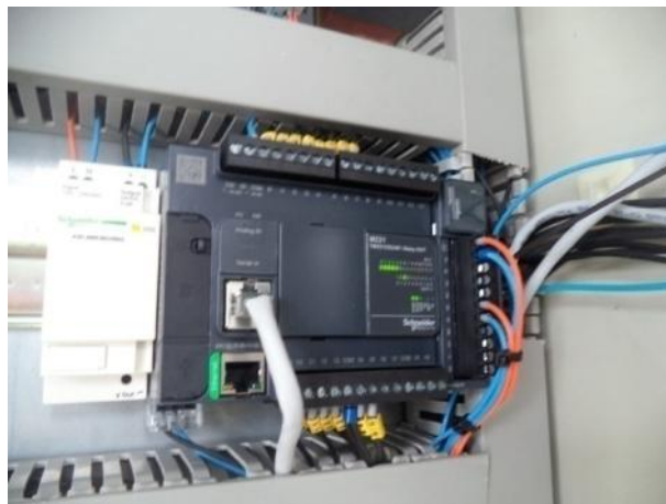
EDAR Xeraco. Mejora del módulo de comunicación con las estaciones de bombeo
