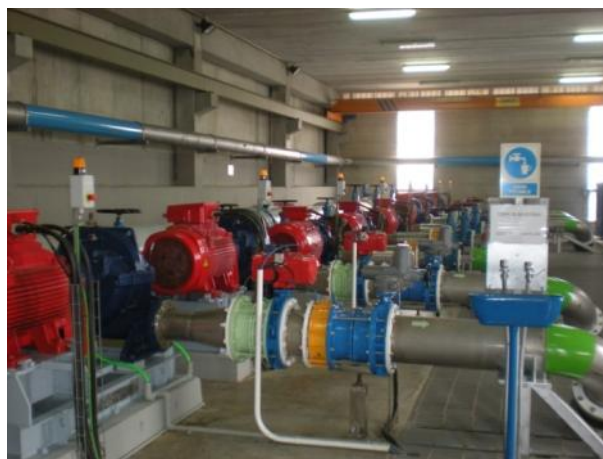
ETAP Sagunto. Impulsión de agua
