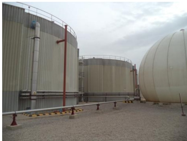
EDAR Albufera - Sur. Gasómetro y digestores
