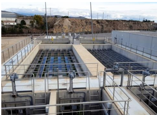
EDAR Alacantí - Norte. Tratamiento terciario
