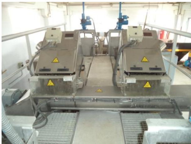
EDAR Alberic. Etapa de tamizado
