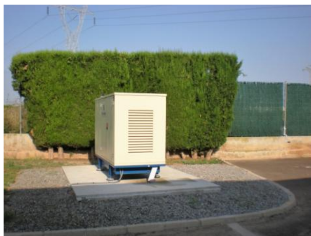
EDAR Bétera. Suministro de grupo electrógeno de emergencia
