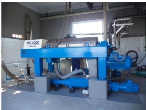
EDAR Sueca – El Perelló. Deshidratación
