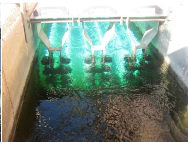
EDAR Sueca. Desinfección mediante UV
