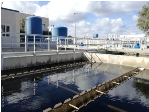
EDAR Pilar de la Horadada. Decantación lamelar
