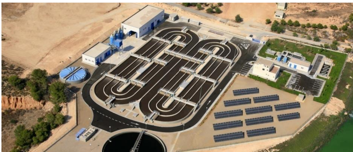
Planta fotovoltaica ubicada en la EDAR de Pilar de la Horadada (Alicante).
