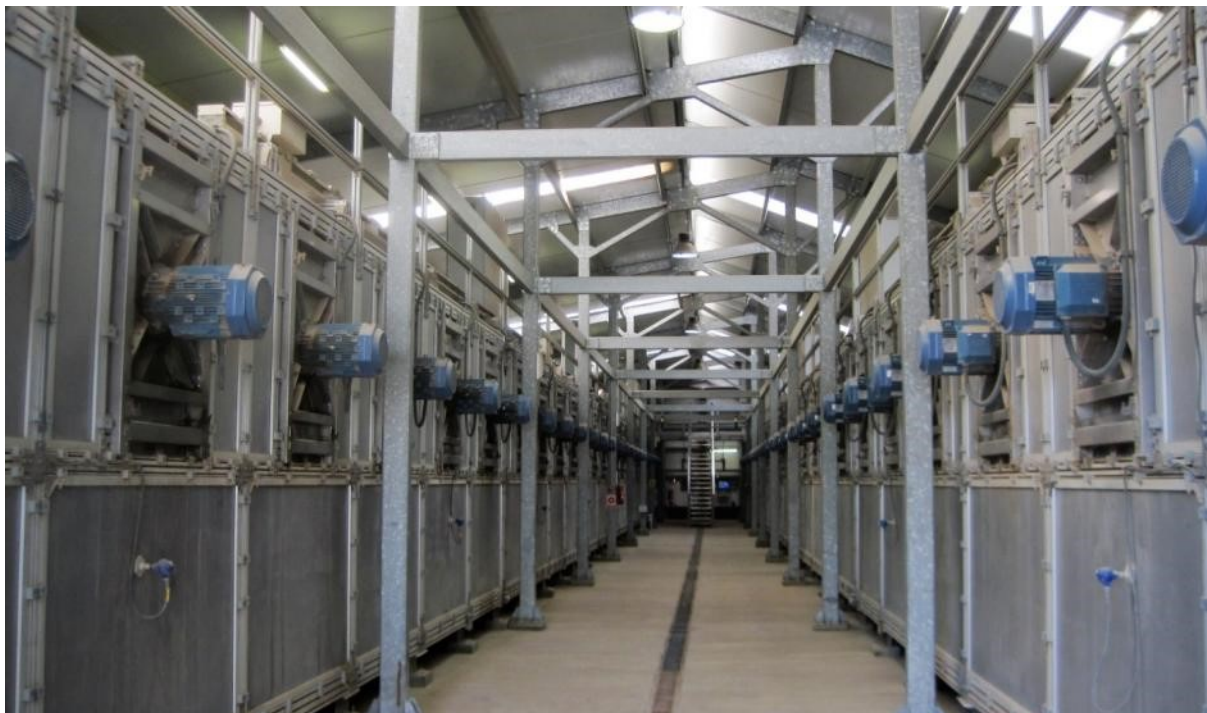
Vista interior del Secado térmico de lodos de Cemex (Alicante)
