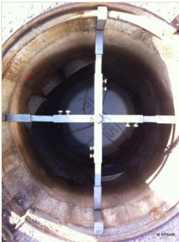
Instal·lació de presa de mostres a l'interior d'una arqueta durant una inspecció
