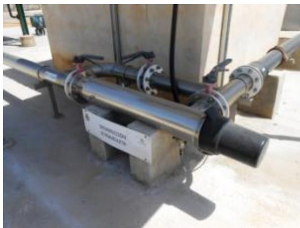
EDAR Loriguilla (Masía del Conde). Desinfecció UV
