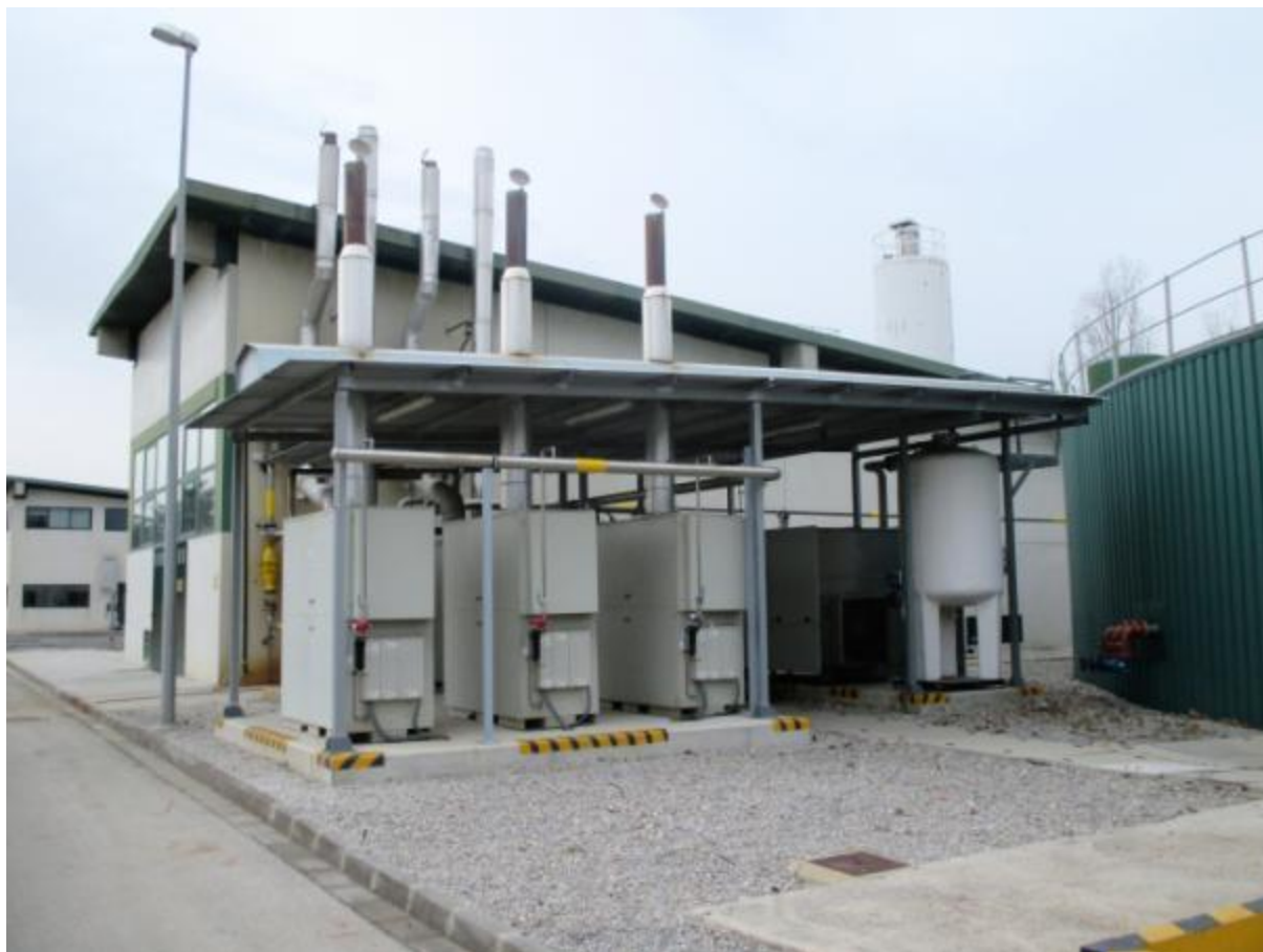
Sistema de cogeneració mitjançant microturbines. EDAR Paterna – Fuente del Jarro
