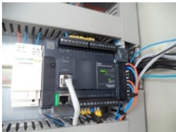
EDAR Xeraco. Millora del mòdul de comunicació amb les estacions de bombament
