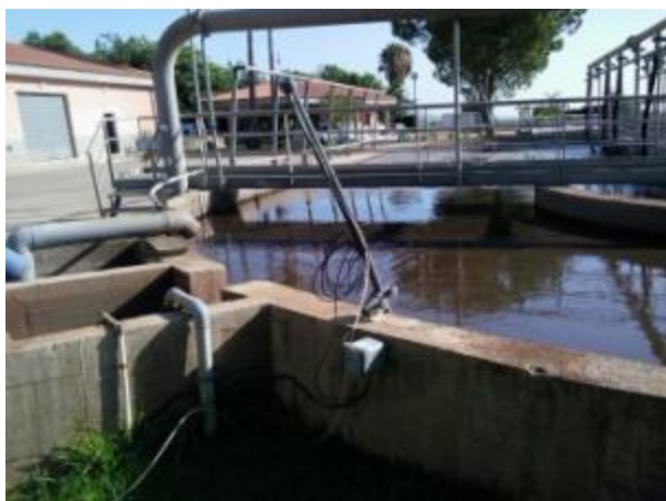
EDAR Pego. Instal·lació de sonda d'amoni per a optimització del tractament biològic
