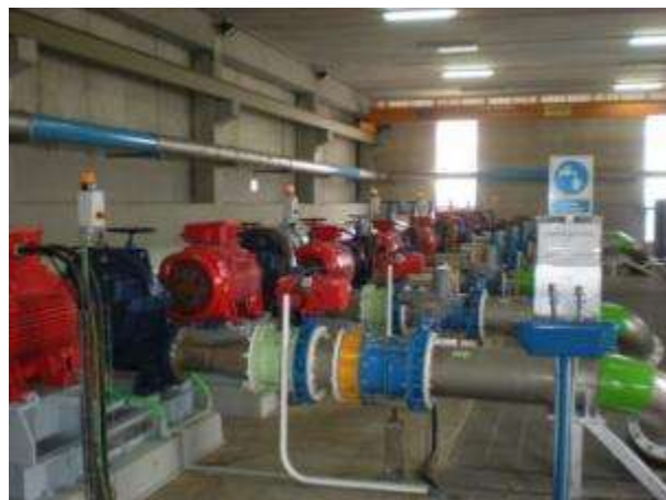
ETAP Sagunto. Impulsió de aigua
