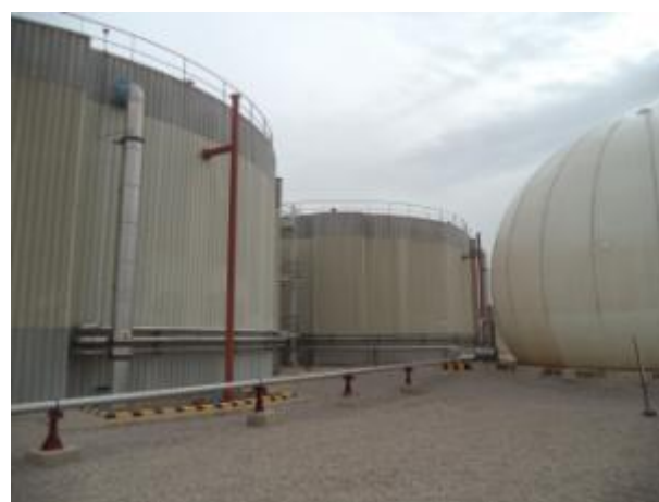
EDAR Albufera - Sur. Gasòmetre y digestors
