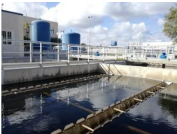
EDAR Pilar de la Horadada. Decantació lamelar
