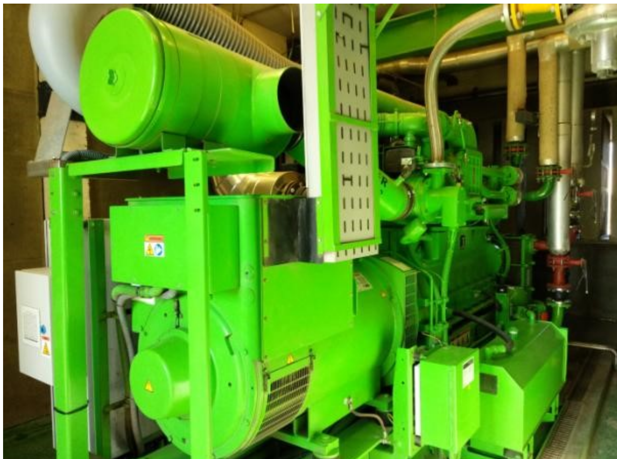
EDAR Sagunt. Motor de cogeneració
