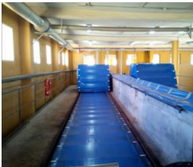
EDAR Calp. Millora eficiència desodoració
