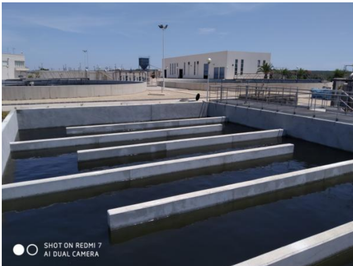
Santa Pola. Instal·lacions per a desinfecció d'aigua tractada
