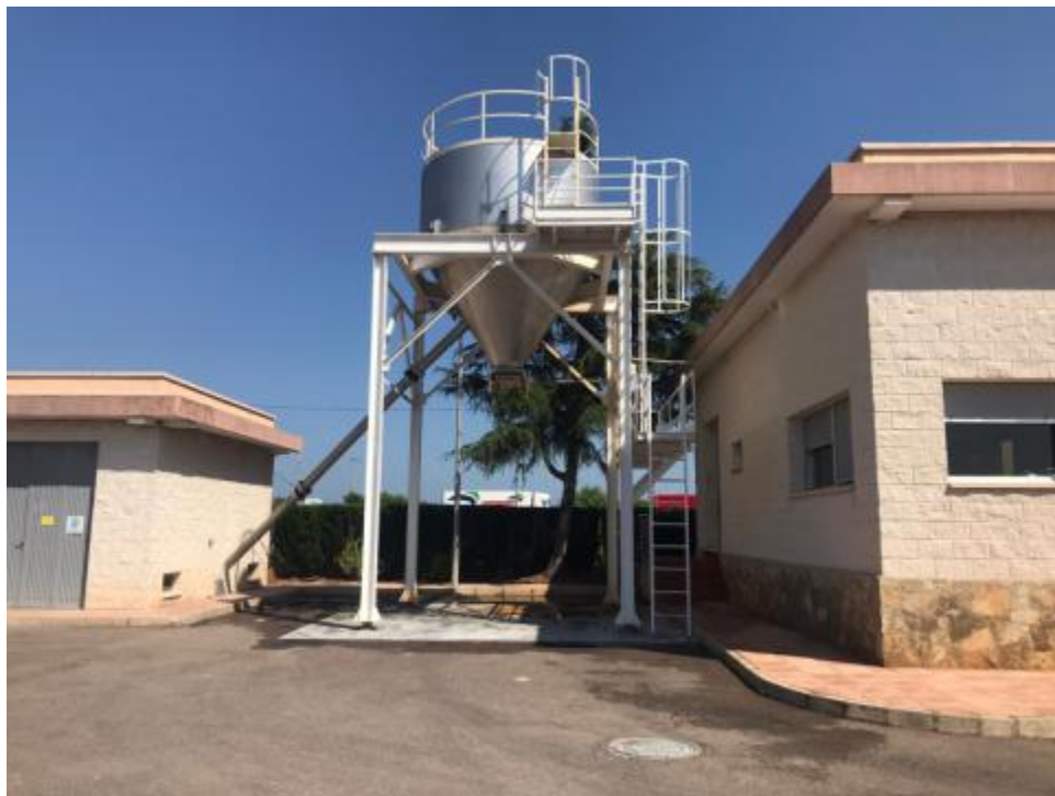
EDAR Almenara. Instal·lació tremuja de fangs
