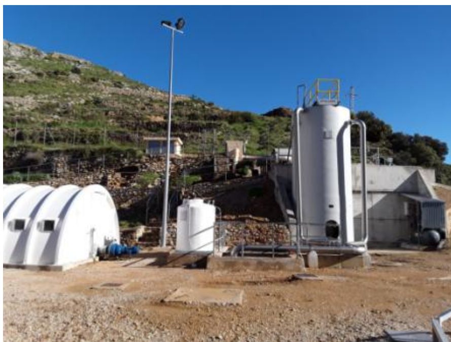
EDAR Vilafranca. Filtres d'arena
