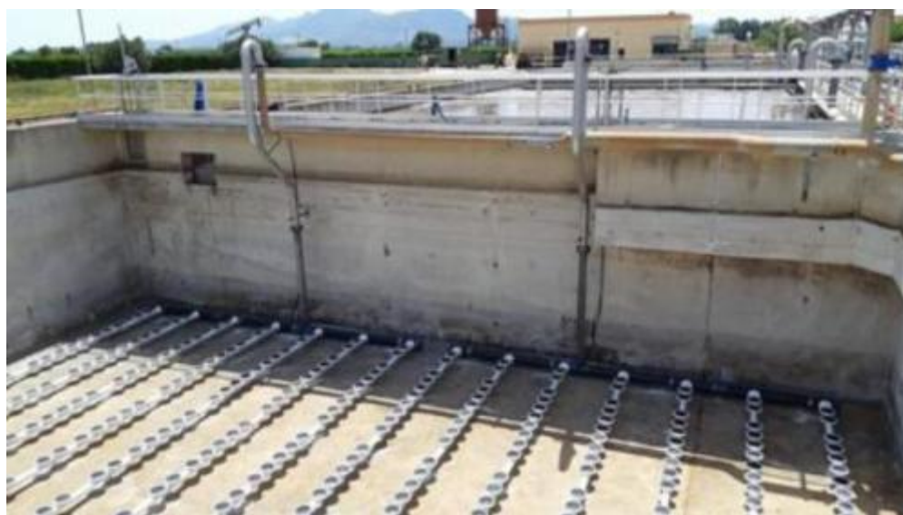
EDAR Algemesí. Difusors basses estabilització per a la desfostació
