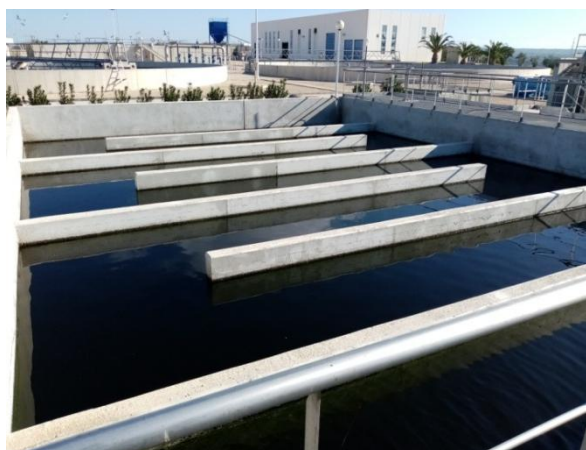
EDAR Santa Pola. Tratamiento terciario
