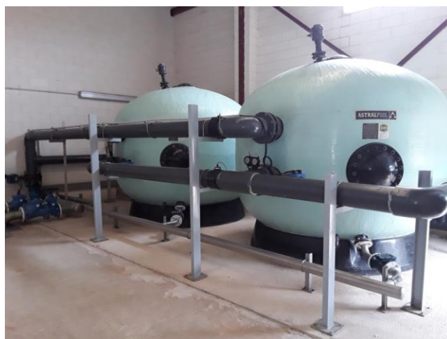
EDAR Sant Jordi-Golf Panorámica. Filtro de arena
