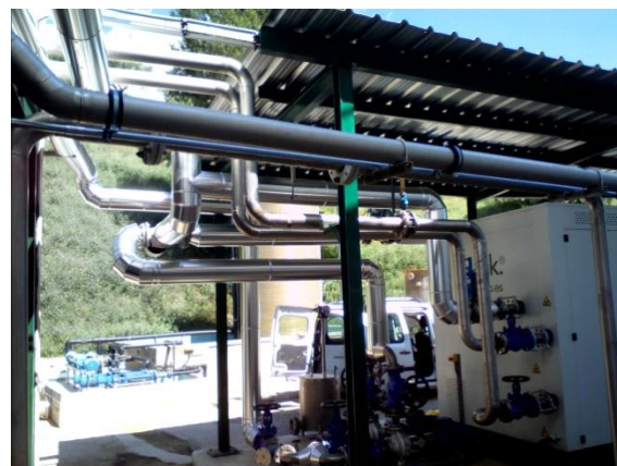
ALCOI: instalación de un equipo de microgeneración eléctrica en el escape del motor de gas natural
