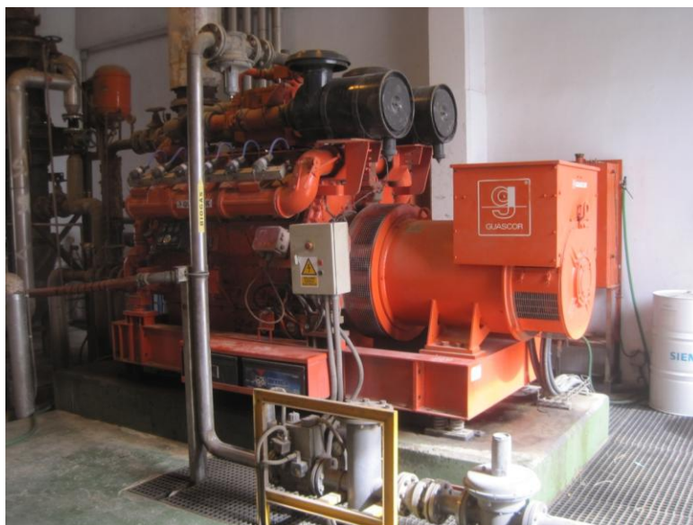
EDAR Rincón de León. Motor de cogeneración
