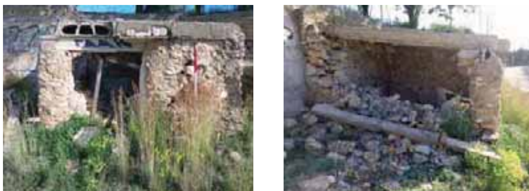
Figura 21 Estructura de piedra en seco en mal estado de conservación con elementos constructivos no tradicionales en tramo urbanizado adosada a un muro de una parcela edificada actualmente.
