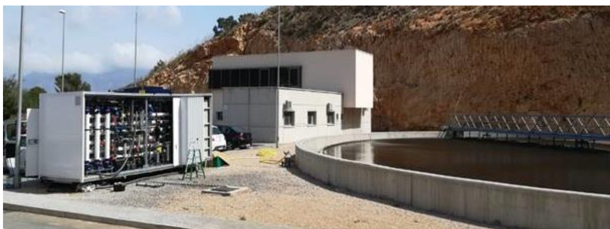
Planta piloto de eliminación de contaminantes emergentes instalada en la EDAR de Benidorm
