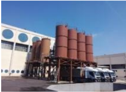
EDAR Pinedo. Ampliación del sistema de almacenamiento de lodos deshidratados
