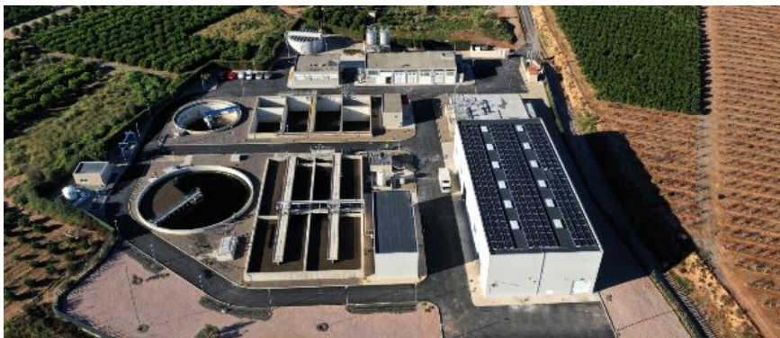
EDAR Bétera. Instalación de placas solares en cubierta del edificio de pretratamiento
