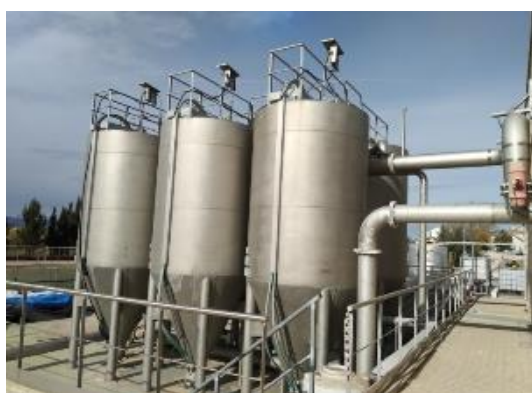
DAR Novelda - Monforte del Cid. Filtración en arena
