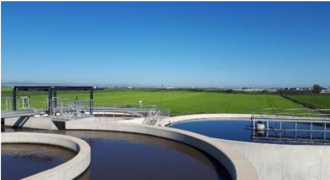
EDAR Sueca – El Perelló. Reactor biológico y decantador secundario.
