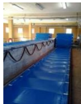
EDAR Calpe. Cubrición y desodorización de los canales de desarenado
