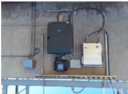
EDAR Alcalà de Xivert (Alcossebre). Automatización de la dosificación de coagulante para la desfostación
