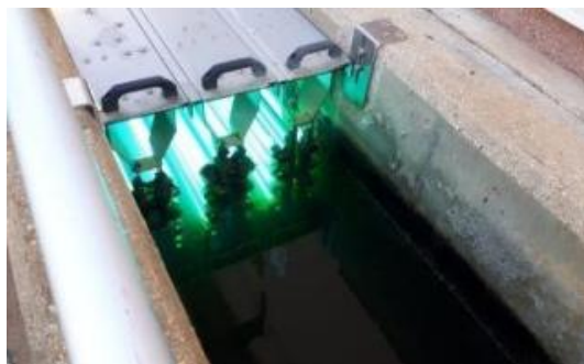
EDAR Sueca. Desinfección mediante UV
