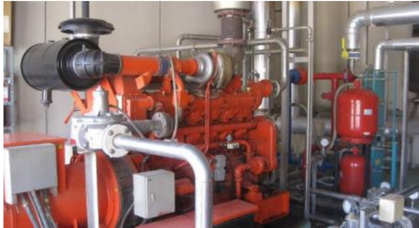
EDAR Benidorm. Motor de cogeneración
