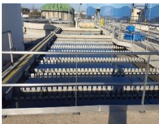
EDAR Pinedo 2. Tratamiento físico - químico
