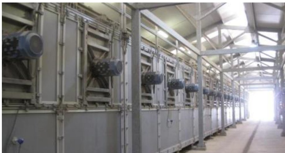
Secado térmico de lodos de Cemex
